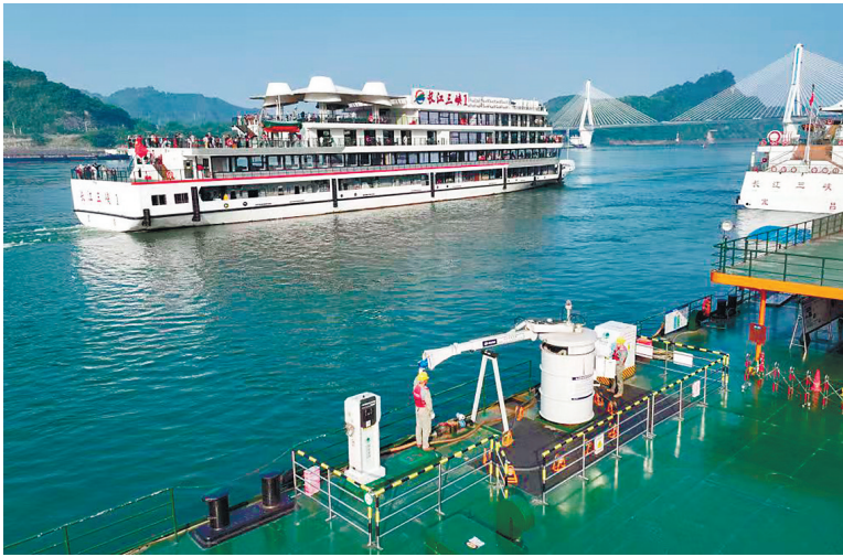
纯电动旅游船“长江三峡1”号驶离后,国网宜昌供电公司岸电运维人员对岸电设备进行巡检(2024年5月23日摄,无人机照片)。
