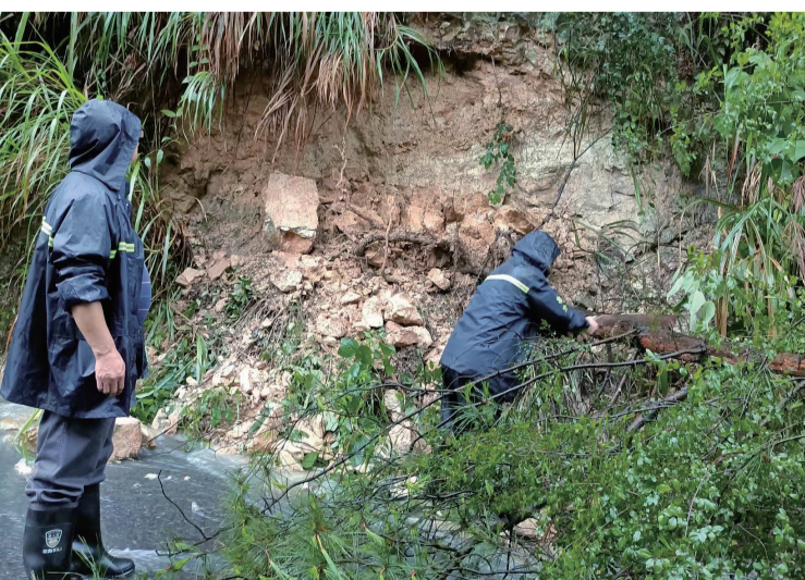
6月20日,江山市四都镇四都村出现塌方,镇村干部第一时间赶到现场开展应急处置。 通讯员 何臻 摄
