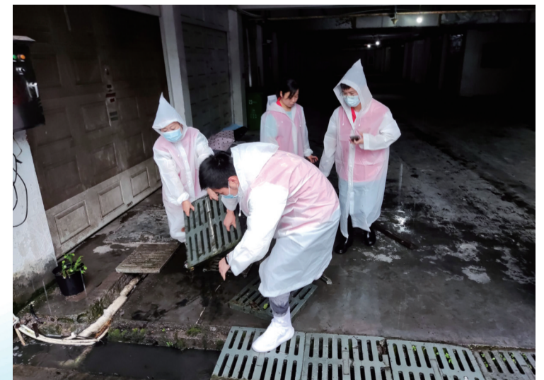
6月20日,柯城区万田乡文景苑社区组团巡查小区防汛隐患点位,在九华北大道裂缝围墙周边加固警戒线,清理小区地下车库门口淤泥,抢修破损路面。 记者 方洁瑶 通讯员 邱芳 摄
