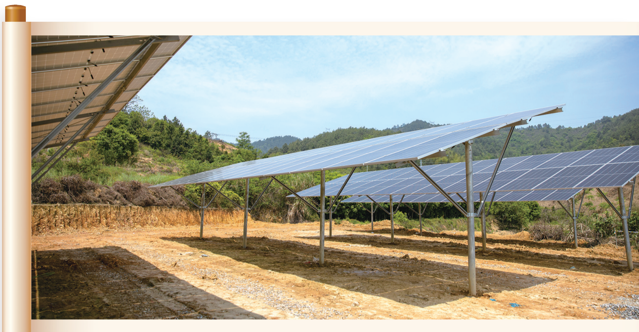
浮河村农光互补光伏架构现场
